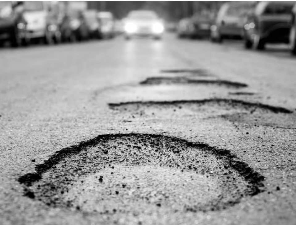
Kaputte Straßen mit Schlaglöchern zählen zu den sichtbarsten Mängeln in der deutschen Infrastruktur.
